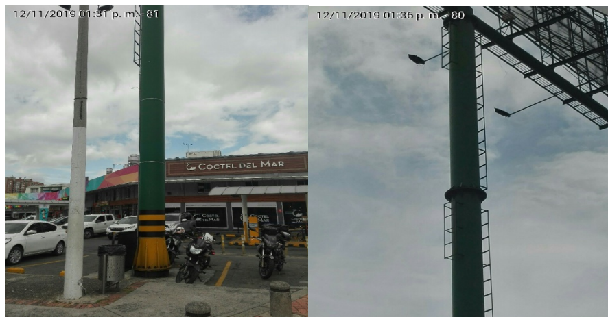
Foto No. 3 y 4: Detalles de la base y del mastil de la valla tubular, en buenas condiciones y estable, instalada en la Av. Carrera 45 No. 183A-86 (dirección registrada) y/o Avenida 13 No. 184-00 (dirección catastral), orientación Este-Oeste .
